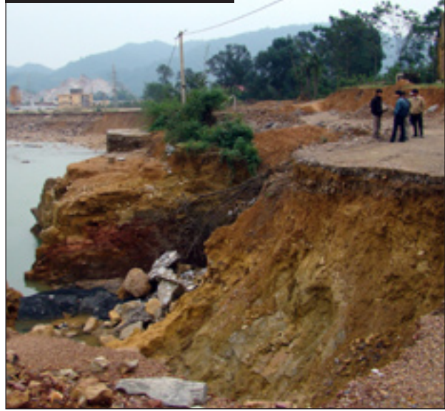
Đường vào nhà máy thủy điện Hồ Hồ đã bị lũ cuốn trôi.
